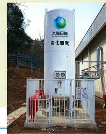
▲液化窒素貯槽
