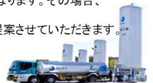
CEタンク(ローリー充填) + 蒸発器
